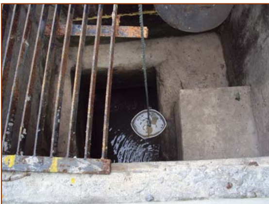
รูปที่ 2 น้ำทิ้งจากท่อระบายน้ำใต้เก่า
