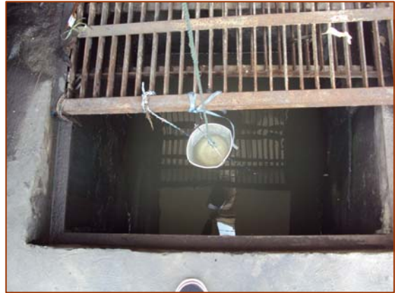
รูปที่ 2 น้ำทิ้งจากท่อระบายน้ำเหนือเก่า
