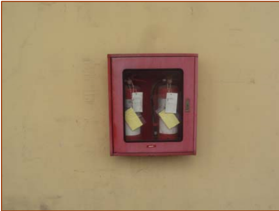
รูปที่ 14 ถังดับเพลิง
