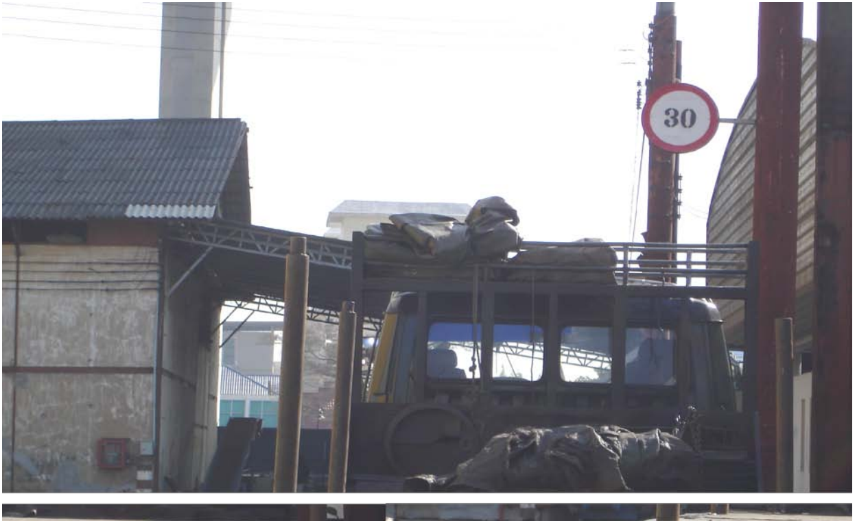
รูปที่ 9 : การติดตั้งป้ายจำกัดความเร็วบนพื้นที่โครงการ
